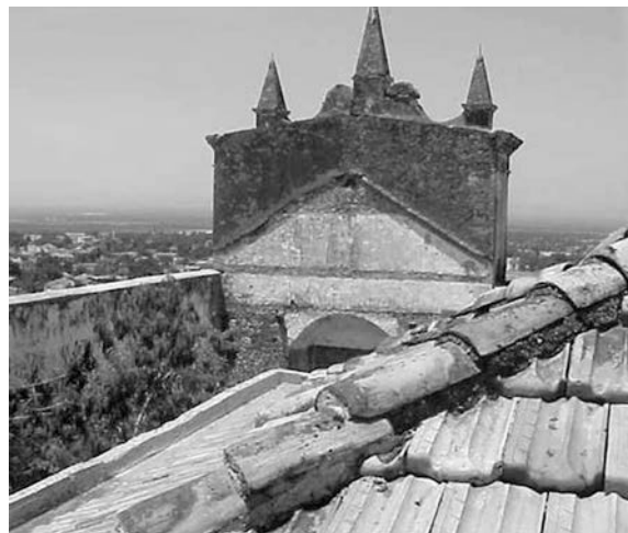
Fig. 20. Nave de la iglesia en el estado actual, carente de cubierta. Trinidad.
