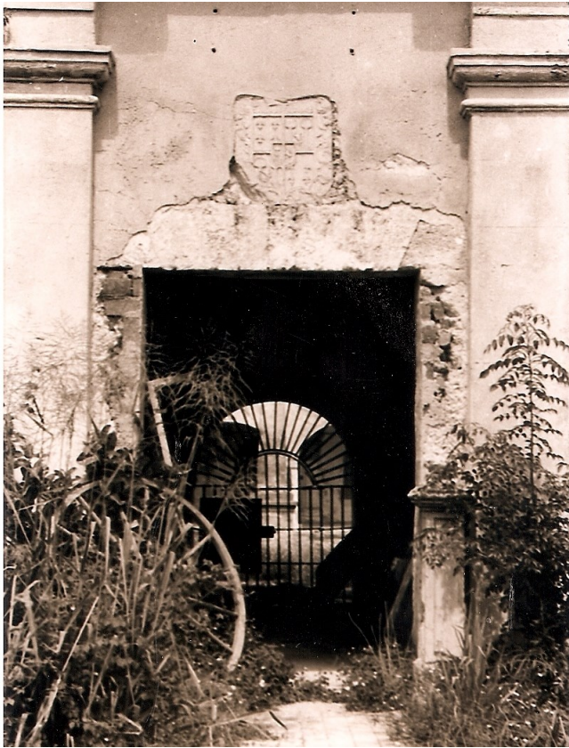
FIG. 3. Portón de entrada en 1989 donde se observa por primera vez la fractura en la esquina inferior izquierda del escudo. Foto de Frank Franco
